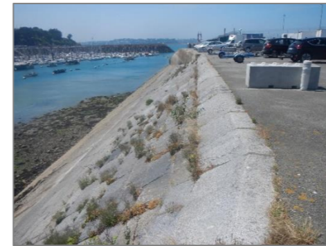
Figure 87 : Statice de Salmon à l'est de la cale du Naye (TBM, 2018)
